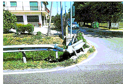
Il guard rail che genera diversi incidenti
