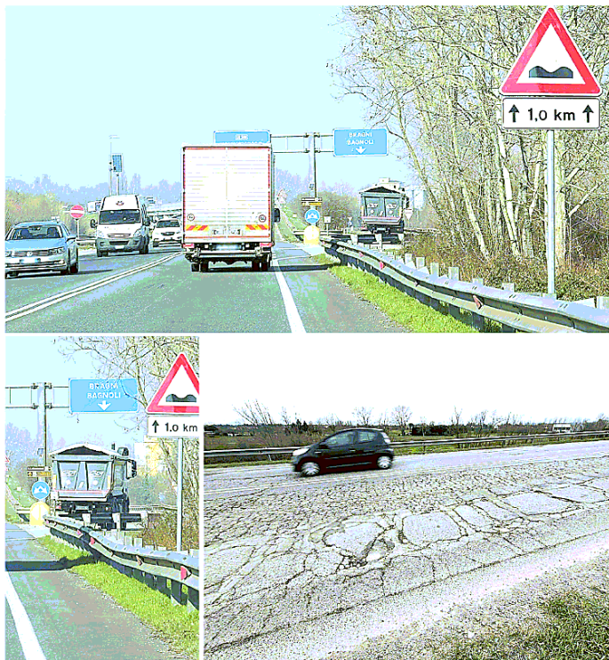
In alto e in basso a sinistra il segnale di "strada dissestata" comparso nel Padovano, lungo la regionale 308, tra Campodarsego e Cadoneghe, dove c'è stato l'incidente. In basso a destra un tratto della stessa strada
