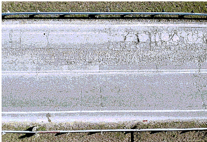
SUL LUOGO DELLO SCHIANTO Il tratto di strada con la buca che avrebbe causato l'incidente
