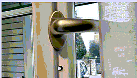
Ecco come i ladri hanno violato le finestre
