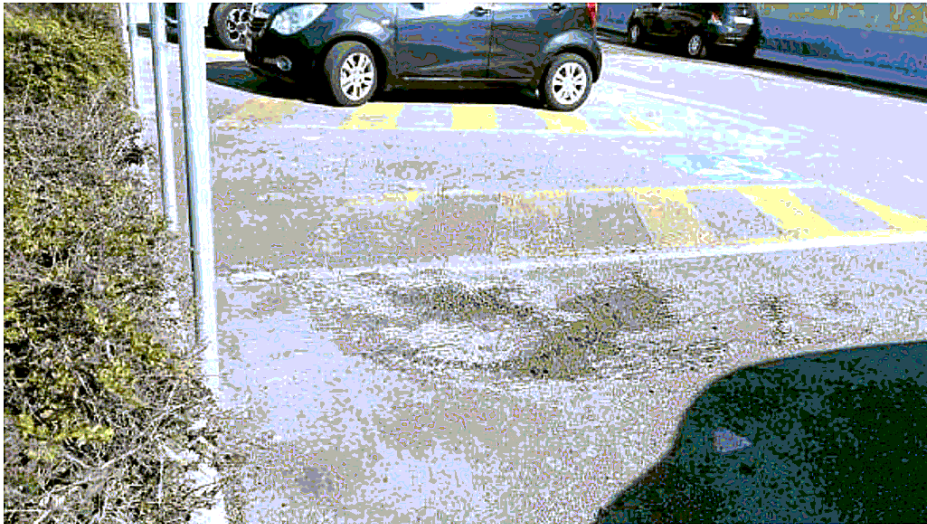
LA VICENDA La buca nel parcheggio del supermercato di Trebaseleghe dove la 55enne è inciampata e caduta ferendosi
