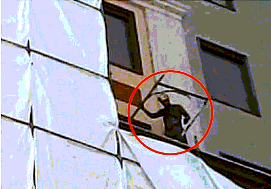
Un operaio sorpreso dal nostro fotografo con un carico sospeso su un ponteggio, senza imbragatura, in zona Porta Venezia
