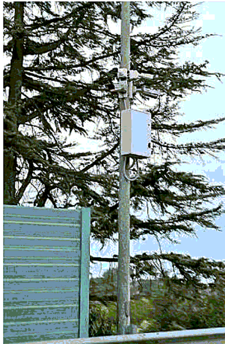
SISTEMI DI CONTROLLI I rilevatori delle targhe all'ingresso della città
