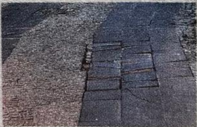
Manto stradale sconnesso
